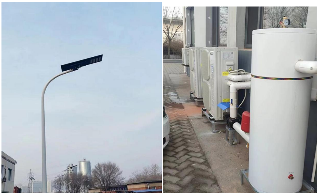
图 2-6 太阳能路灯及空气源热泵技术
